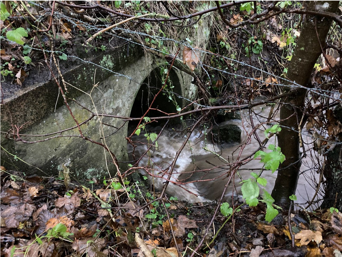
Figur 5. Styrt ved indløb i rørledning, december 2021
